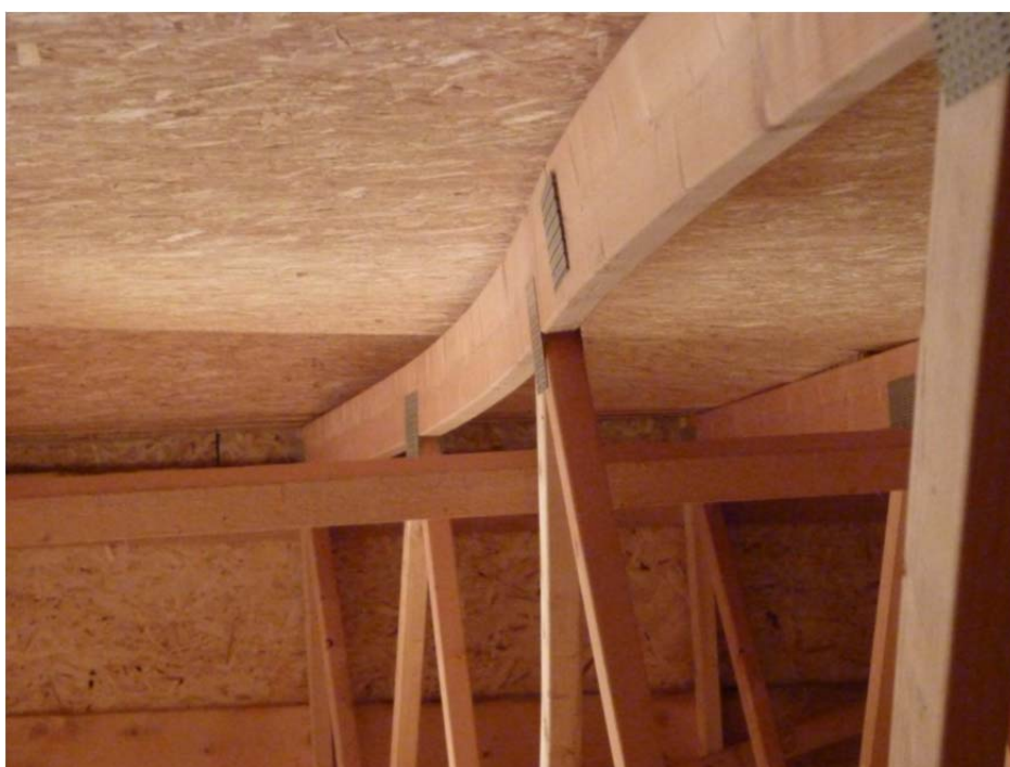
Figur 2 Ustabil spærhoved pga. manglende sømning
